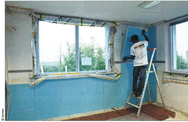
© Isover Pose du système de panneaux sous vide Optima-PIV. Le calepinage est préparé en amont et complété par un calfeutrement avec de l'isolant GR 32.
